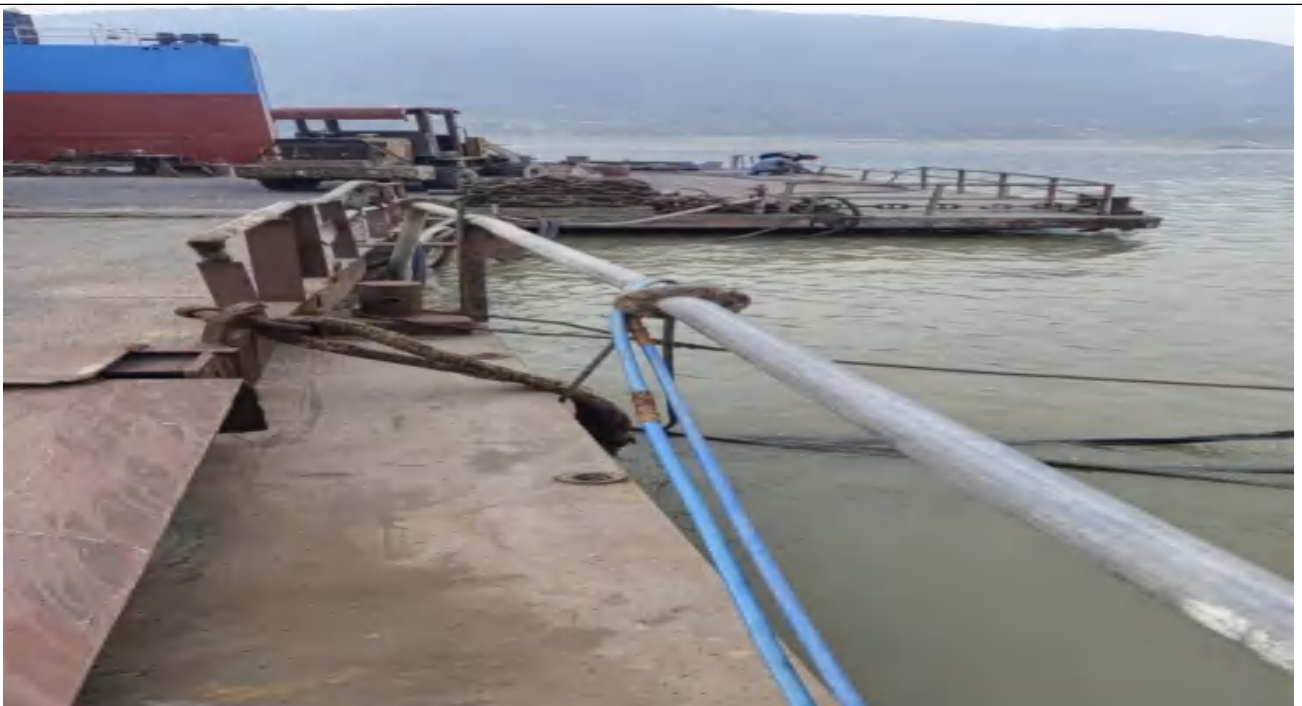
船坞废水与船厂地面废水收集池连接管道
