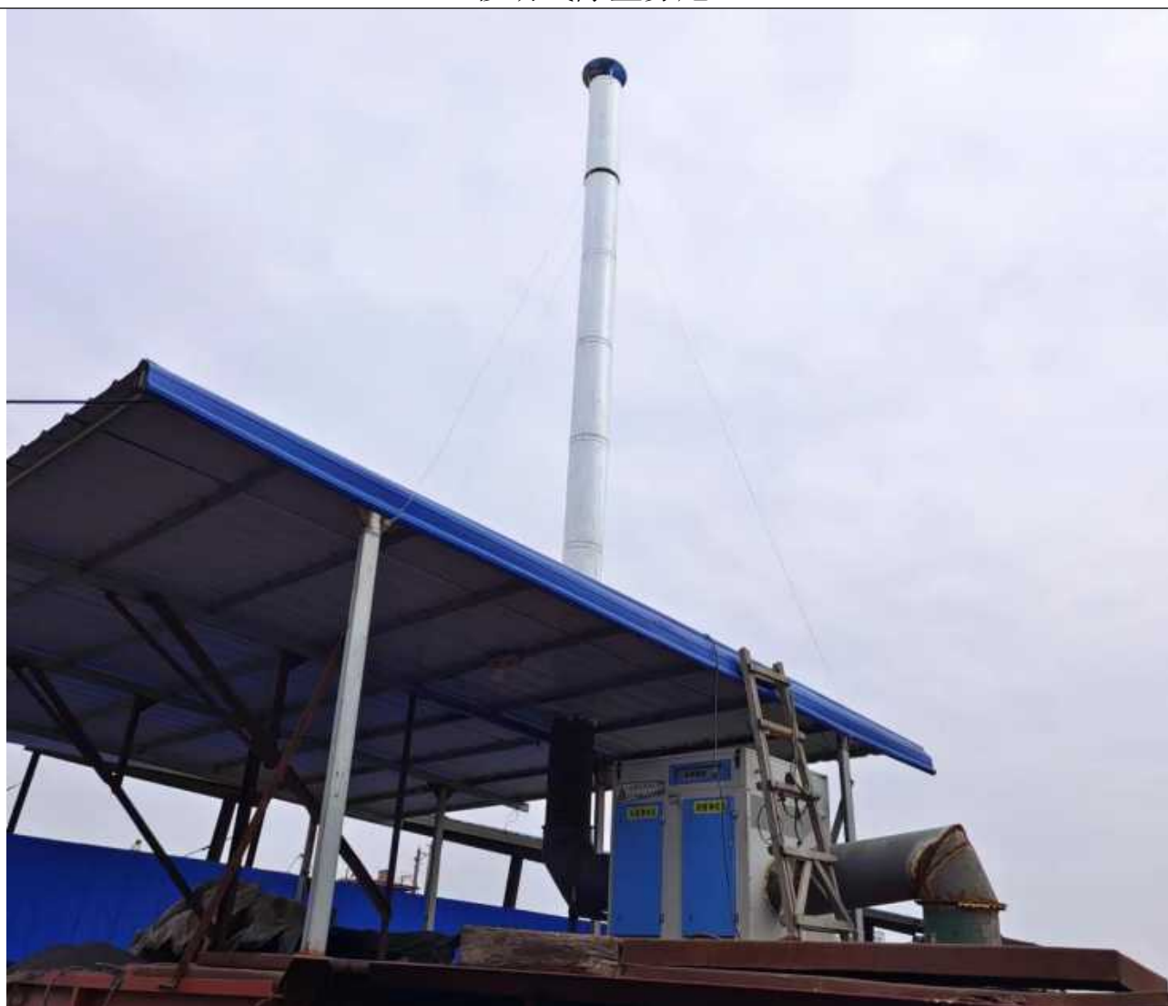
调漆房排气筒
