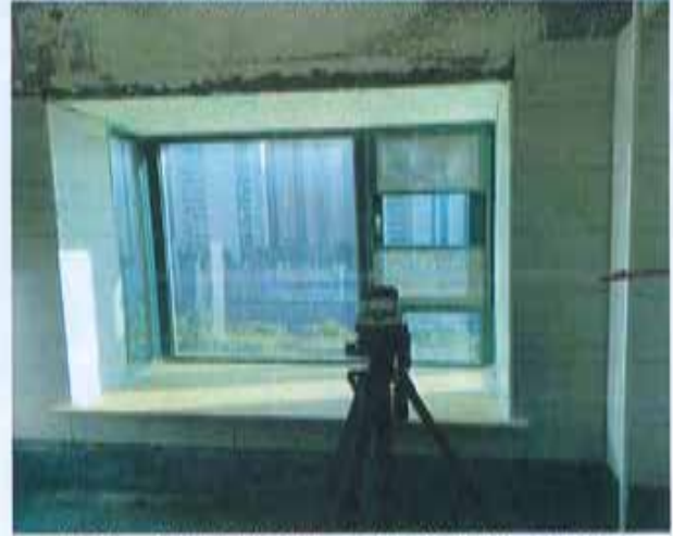
图 28: 23#17 栋 2 单元 601 临铁路一侧卧室
