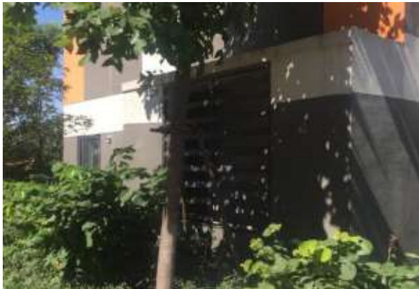
地下室排风口（地面）
