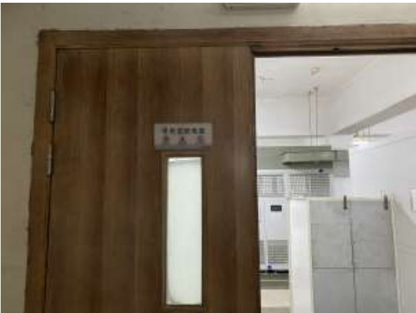
地下室配电房大门
