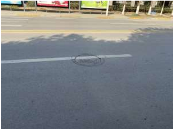
光谷创业街污水排口 2#
