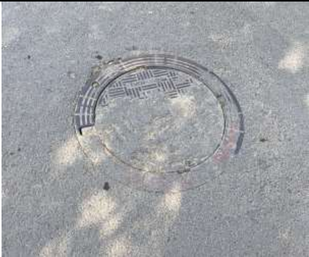
光谷创业街污水排口 1#
