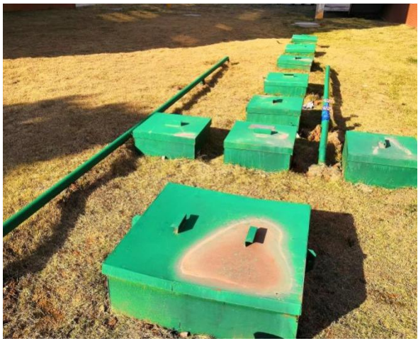
项目自建污水处理站
